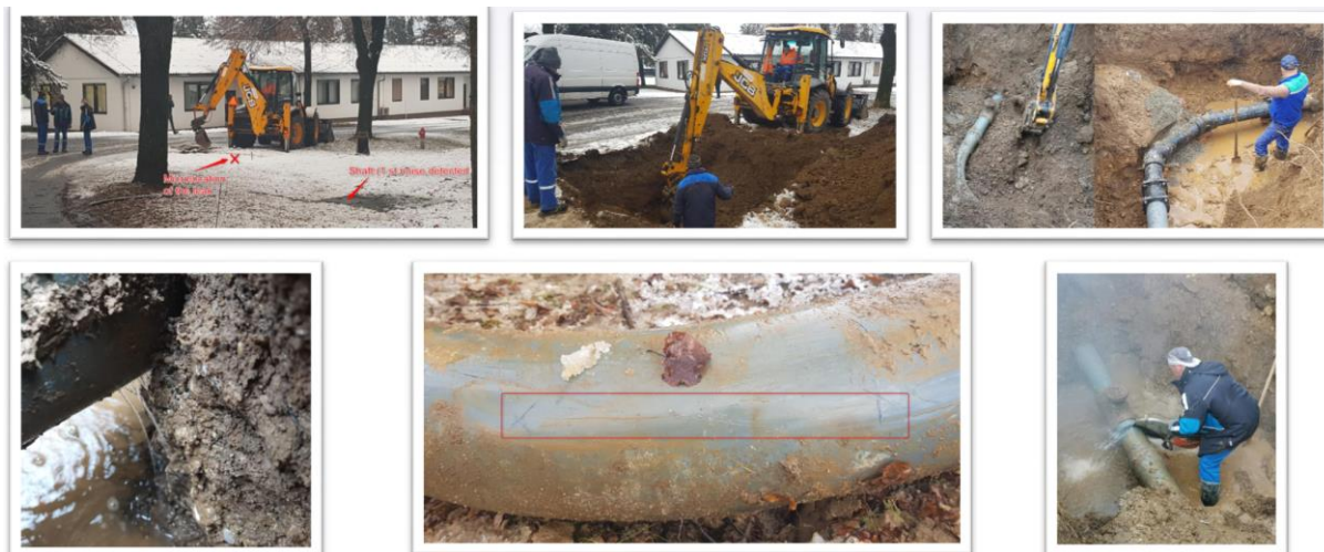
Slika 3: Prikaz detekcije izteka vode na terenu
